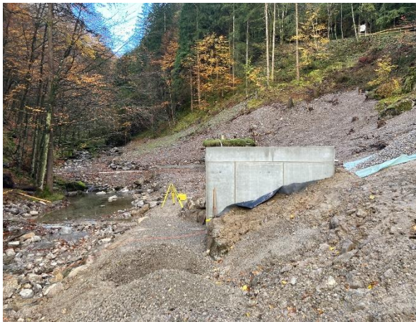
Abb. 3.4: Brunnenstube Gätteri 2023 (Foto L&H; 7.11.2023)
