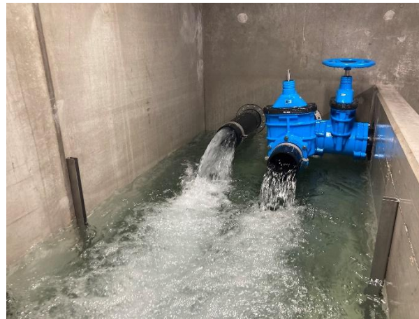
Abb. 3.5: Brunnenstube Gätteri 2023 (Foto L&H; 7.11.2023)
