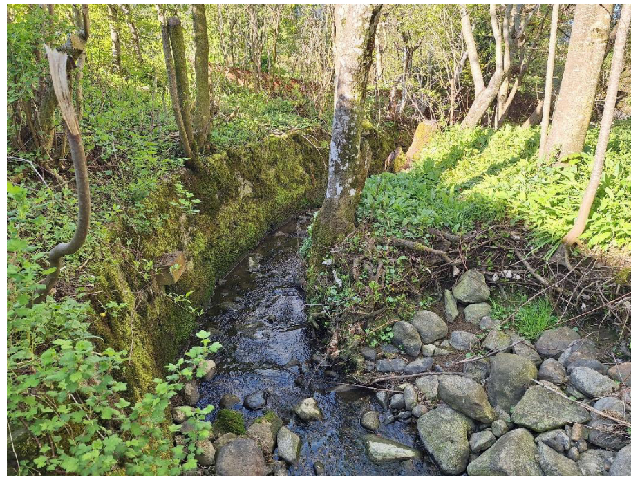
Engstelle zwischen Profil 851.35 und 827.55 mit der linksufrigen Betonmauer und der markanten Ufererosion. Blick in Fließrichtung
