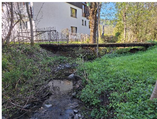
Abbildung 11: Brücke mit ungenügendem Freibord m 867
